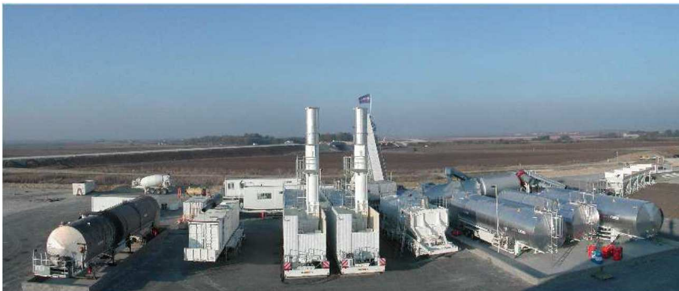
Illustration n° 5 : Photographie d'une centrale d'enrobage de type TSM28
